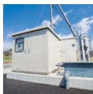
排水処理設備
