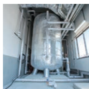
貯蔵槽タンク
