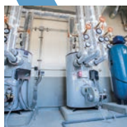
軟水機・ボイラー
